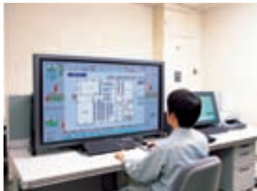
マルチファシリティーズ（総合ビルマネジメント）
